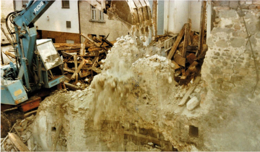
Mutwilliger Abbruch der Stadtmauer in der Löwengasse 10 im Jahr 1983 (Foto: Verfasser)
