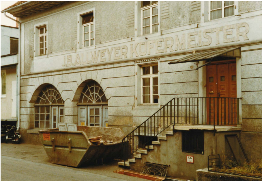
Löwengasse 10, Demontage eines Denkmals: Die Vorfenster und Fensterläden befinden sich bereits in der Mulde, die im gleichen Stil wie die Torbögen geschmiedeten Kellergitter sind bereits herausgetrennt. (Foto: Verfasser, kurz vor dem Abbruch 1983)
